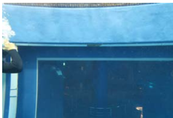
経年劣化による破損部の変化を観察
